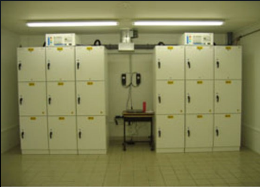
Armoires sous azote - Local sécurisé
