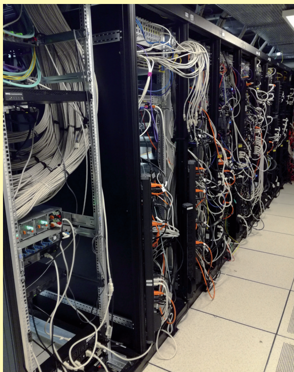
Salle serveur du LPNHE.
