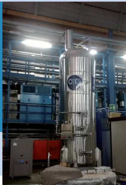
Le système de stockage xénon ReStoX2 dans les sous-sols du LNGS.
